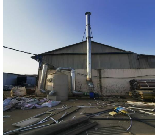
图2 破损电池暂存间废气处理装置
